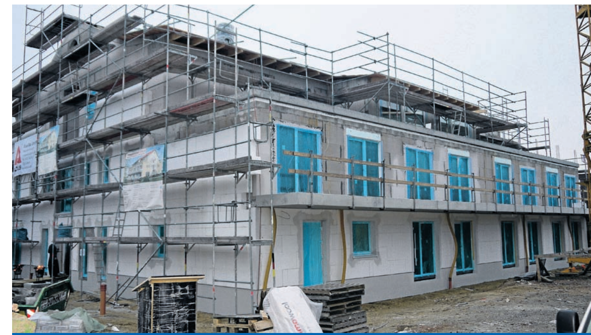
Wo heute noch der Rohbau steht und der Richtkranz auf dem Dach weht, werden ab Februar 2014 die neuen Bewohner eine schöne neue Heimat finden
